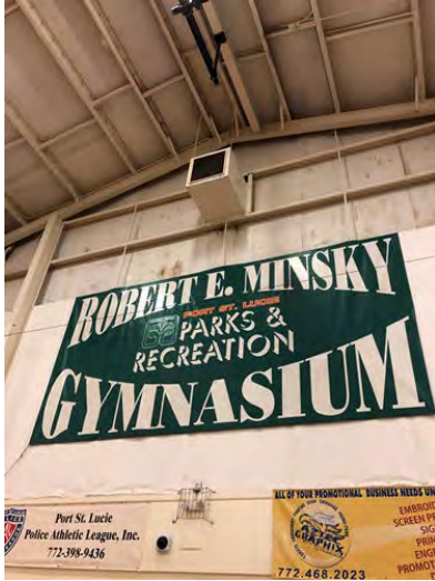
Photo: Gym Exhaust Fan
