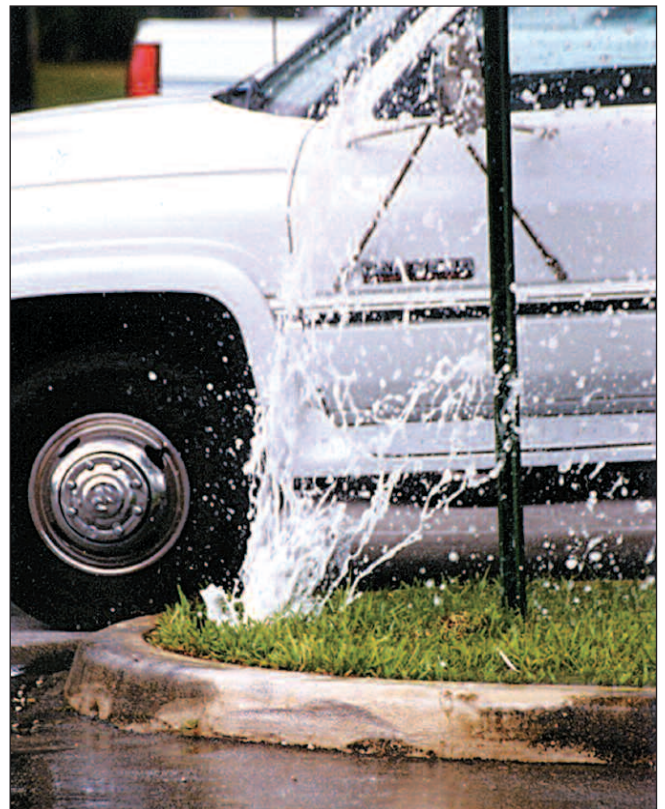
Figura 11. P3rdida de agua debido a la ruptura del dispersor.
